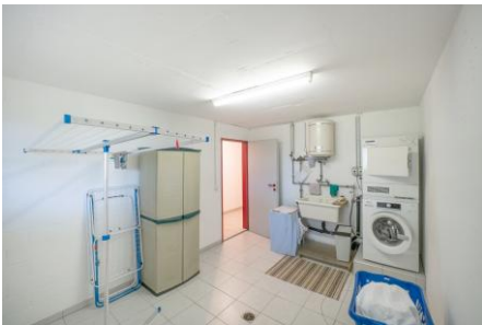
Private Waschküche mit Waschturm
